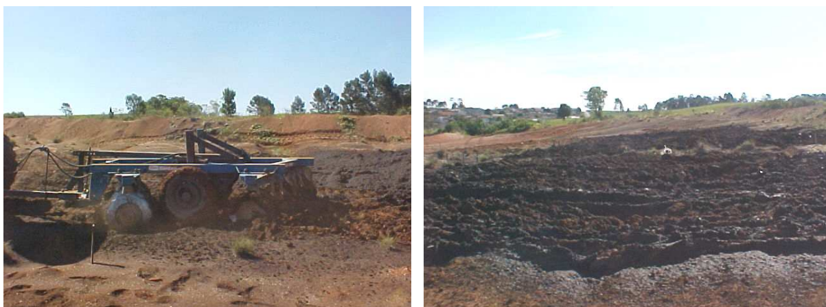
FIGURA 07: DETALHE DA GRADE NA INCORPORAÇÃO DO BISSÓLIDO E ÁREA APÓS APLICAÇÃO E INCORPORAÇÃO. JANEIRO DE 2003. AEROPORTO INTERNACIONAL DE CURITIBA.
