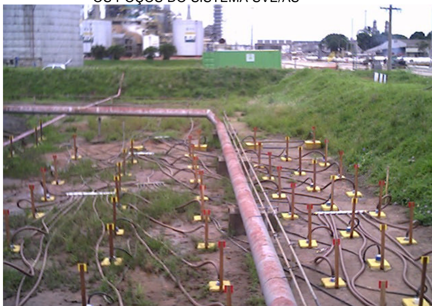
FIGURA 4.14 - VISÃO GERAL DO LOCAL ONDE ESTÃO INSTALADOS OS POÇOS DO SISTEMA SVE/AS
