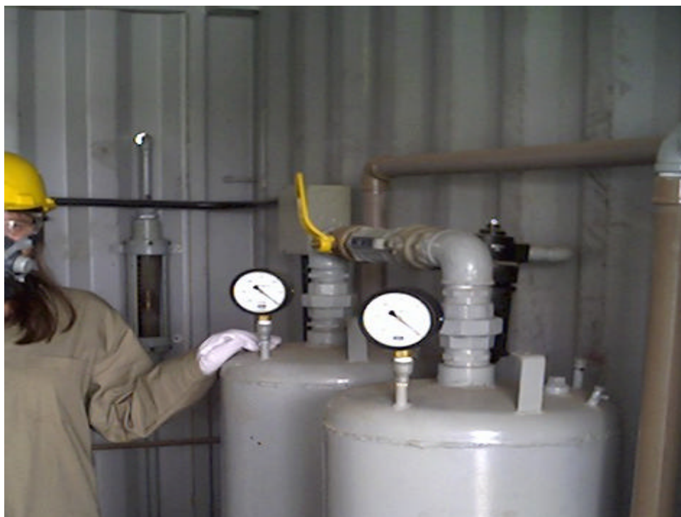
FIGURA 4.17 - FILTROS DE CARVÃO ATIVADO E FILTRO COALESCENTE
