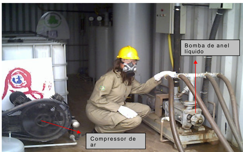
FIGURA 4.16 - BOMBA DE SUÇÃO DE AR E COMPRESSOR DE INJEÇÃO DE AR
