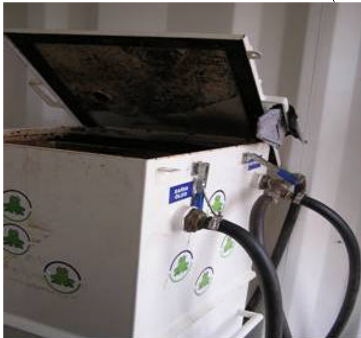
FIGURA 4.12 - CAIXA SEPARADORA DE ÓLEO E ÁGUA (SAO)
