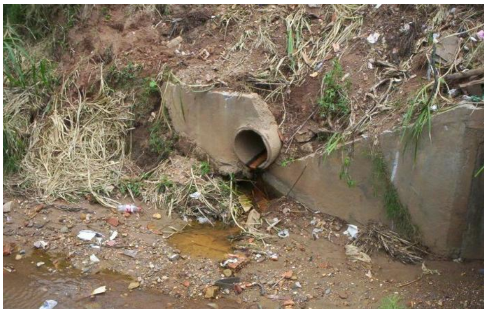
FIGURA -23 LANÇAMENTO DE ÁGUAS SERVIDAS
